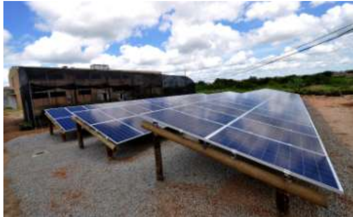
Figura 4.16 - Usina solar fotovoltaica instalada no câmpus Pombal
